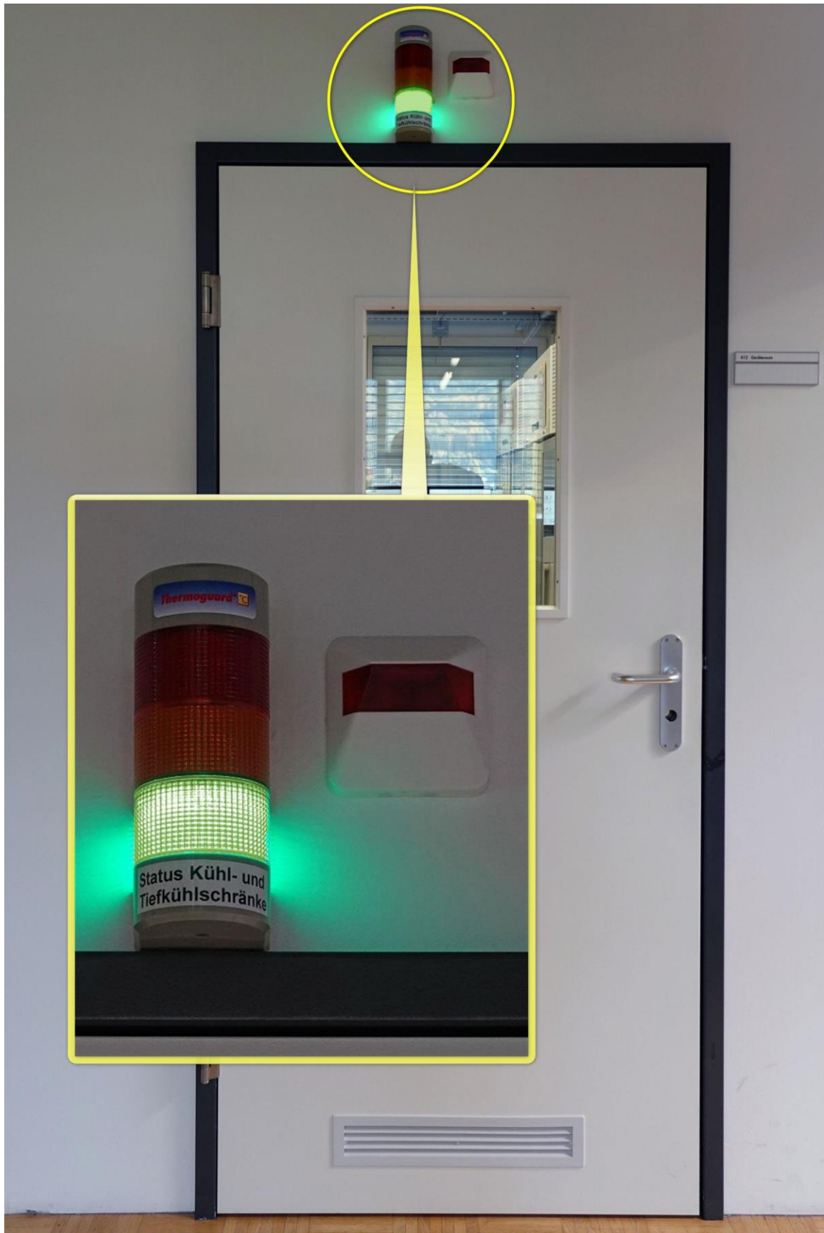
Signalsäule 3fach rot-gelb-grün über der Tür des zu überwachenden Raumes
