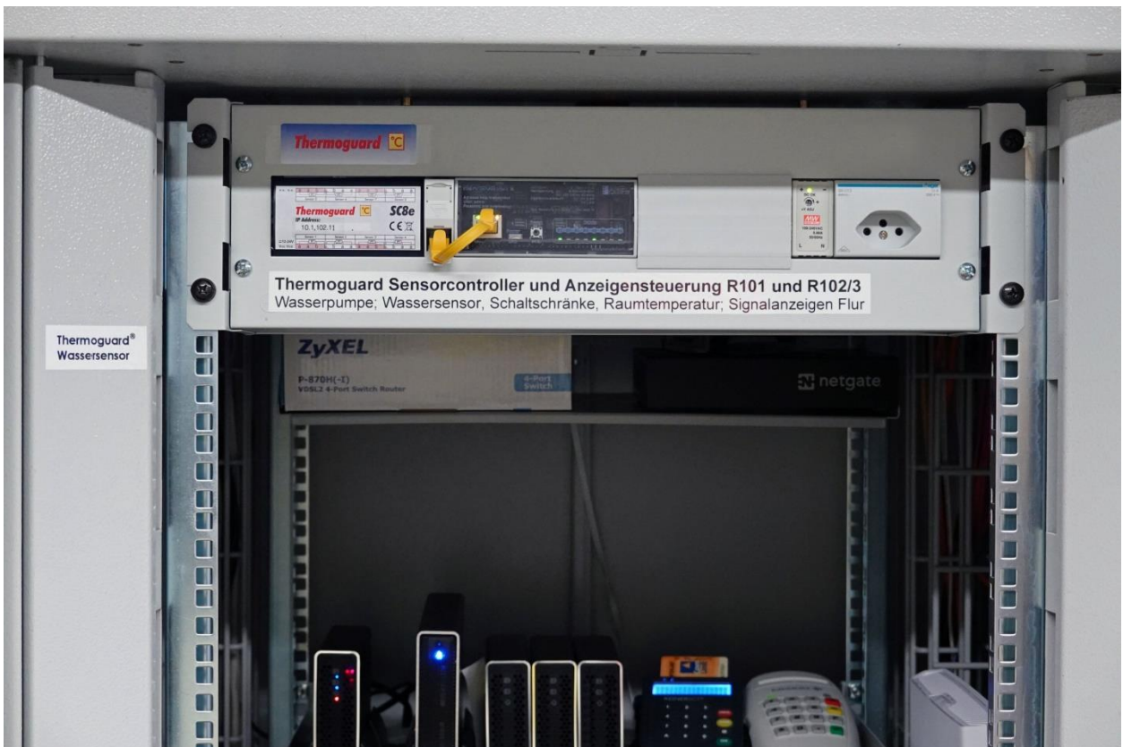
Die Ansteuerung dazu in einem 19" Server-Rack
