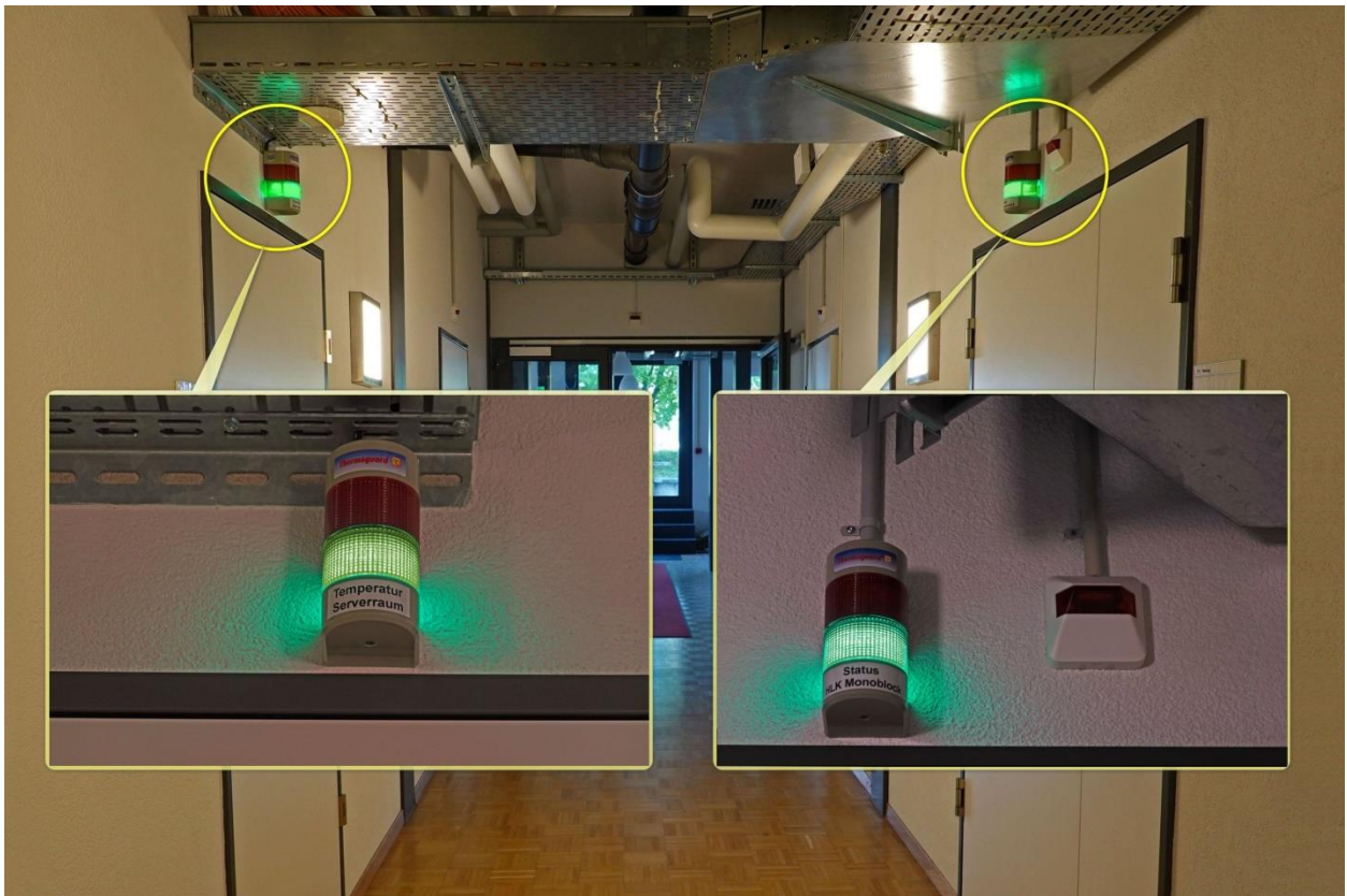
Zwei Signalsäulen 2fach rot-grün im Flur über den Türen der "zugehörigen" Räume
